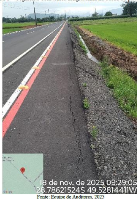
Figura 8 – Segmento com trinca longitudinal na borda do pavimento
