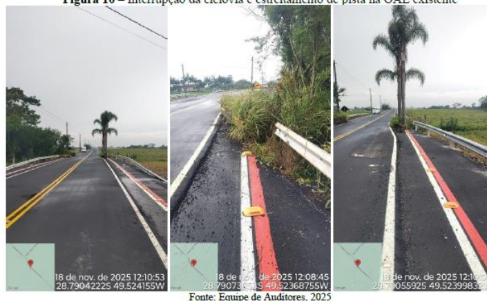
Figura 10 – Interrupção da ciclovia e estreitamento de pista na OAE existente
