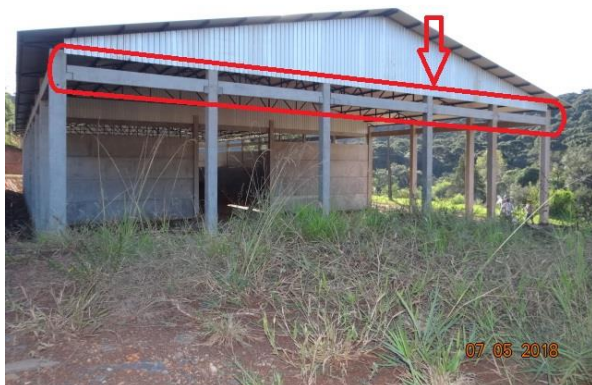
Foto 5 - Abertura deixada pela construtora entre o fechamento e a viga, incompatível com o projeto mostrado na figura a direita.
