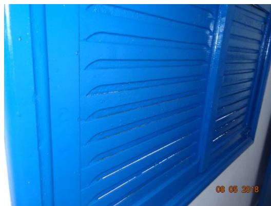
FOTO 30 – O serviço de pintura das esquadrias é de baixa qualidade.
