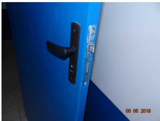
FOTO 11 – Os serviços de pintura são de baixa qualidade.
