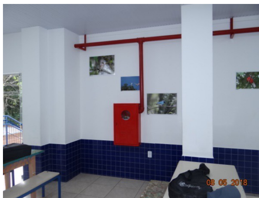
FOTO 20 – Detalhe do sistema hidráulico preventivo de incêndio. Pastilhas até 80cm nas paredes.
