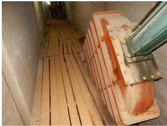
Foto DSCN1044: Galeria de inspeção. Madeiras continuam soltas e, em alguns casos, apodrecendo. Algumas ripas antigas foram trocadas por novas.
