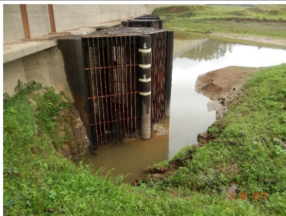
Foto DSCN0991: Tomada d'água.
