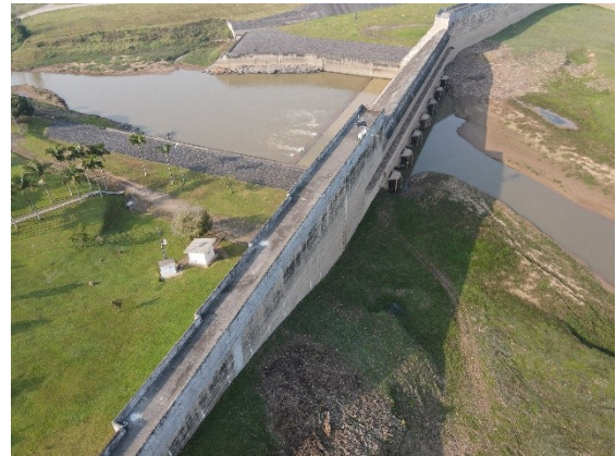
Foto DJI0625: Paramento de montante sobre-elevado.
