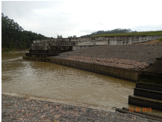
Foto DSCN1197: Muro executado, assim como colchões de gabião nas duas margens.
