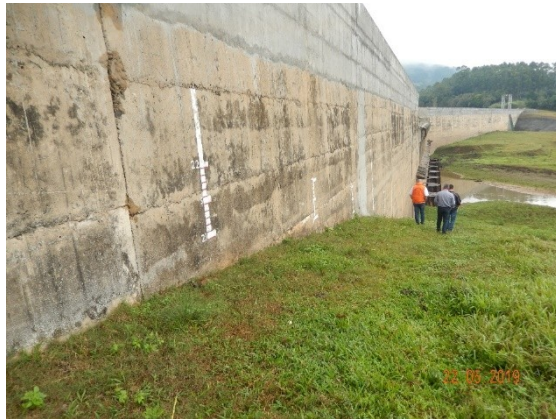
Foto DSCN0986: Paramento de montante sobre-elevado.
