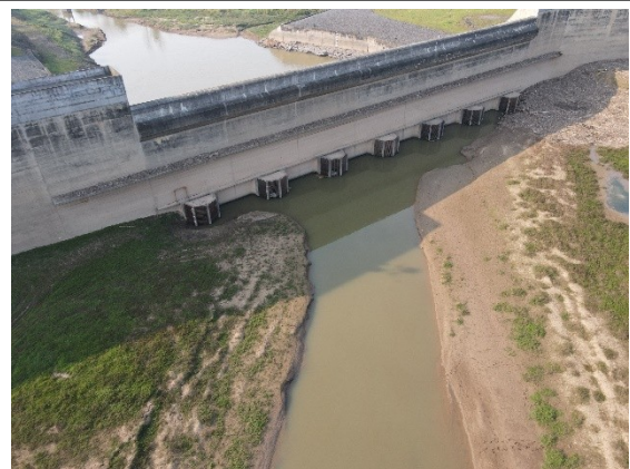
Foto DJI0626: Tomadas d'água. Nota-se o assoreamento do canal do rio e a Comporta 7 (à direita) com muito material à volta.
